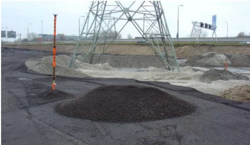
Figuur 5.1 Locatiefoto ten tijde van demping in 2007 (bron: medewerker Rijkswaterstaat)
