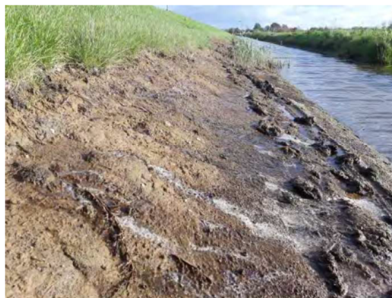
Figuur 2.4: foto met lekkage uit talud aanberming
