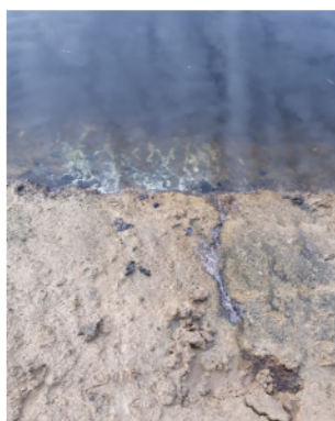
Figuur 4.4: foto met lekkage uit talud aanberming
