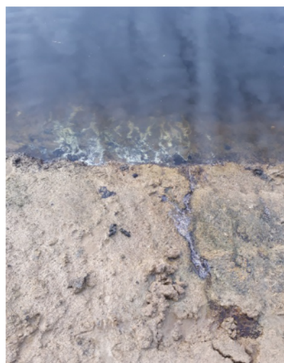
Figuur 4.4: foto met lekkage uit talud aanberming
