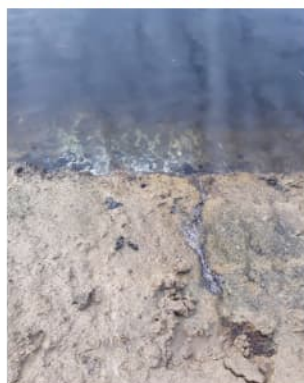
Figuur 4.4: foto met lekkage uit talud aanberming
