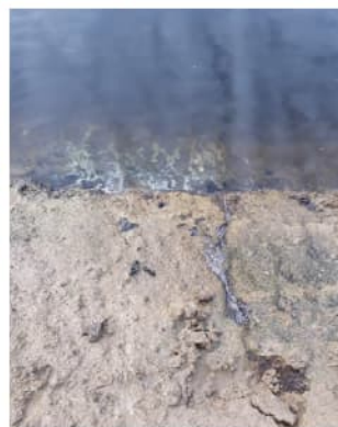
Figuur 4.4: foto met lekkage uit talud aanberming
