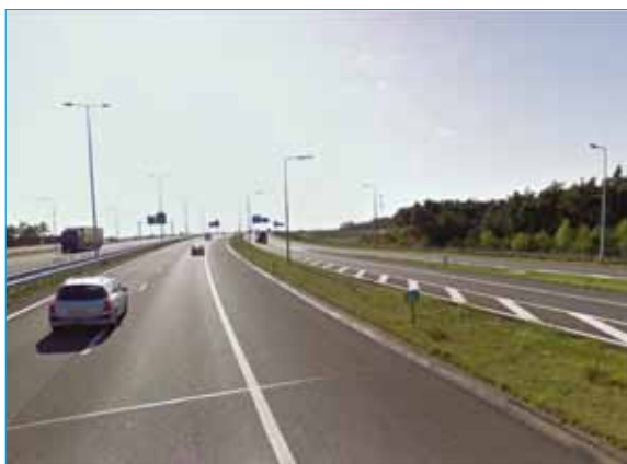
Foto 3: Tussen de hoofdrijbaan en de rangeerbaan op de A73 in de bocht ter hoogte van het knooppunt ontbreekt de geleiderail.
