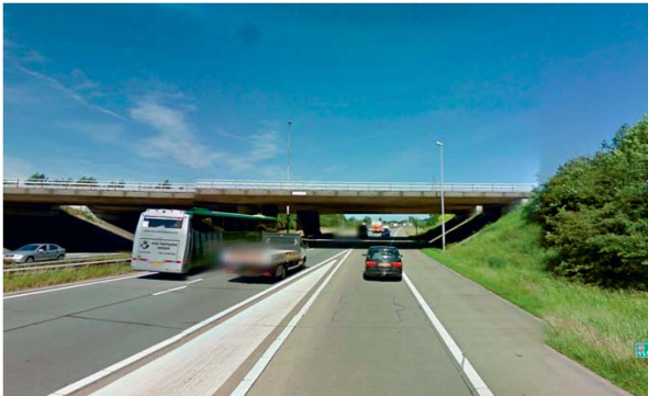
Foto 1: licht-donkerovergang ter hoogte van het begin van de invoegstrook (bron: Google Streetview)
