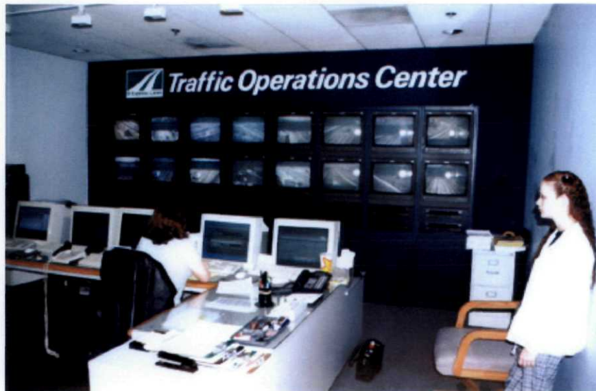
Figuur 25 De mini verkeerscentrale
